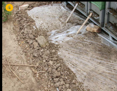
A régi és az új hullák elkülönítése fóliatakarással
